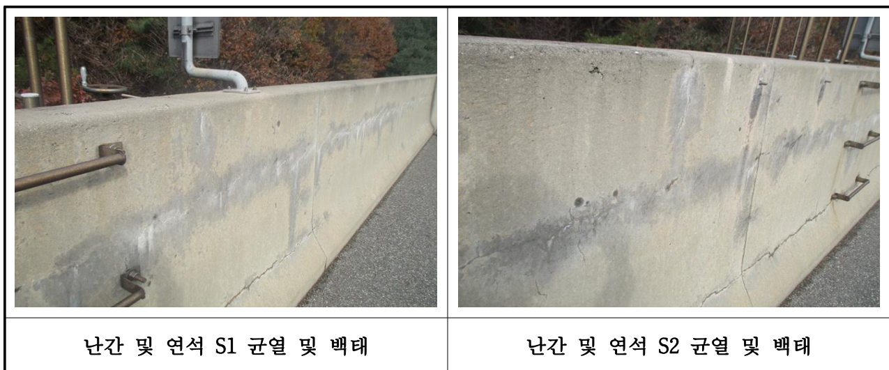
【사진 3.41】 난간 및 연석 손상현황
