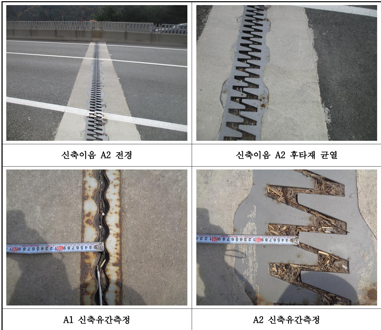
【사진 3.35】 신축이음장치 손상현황
