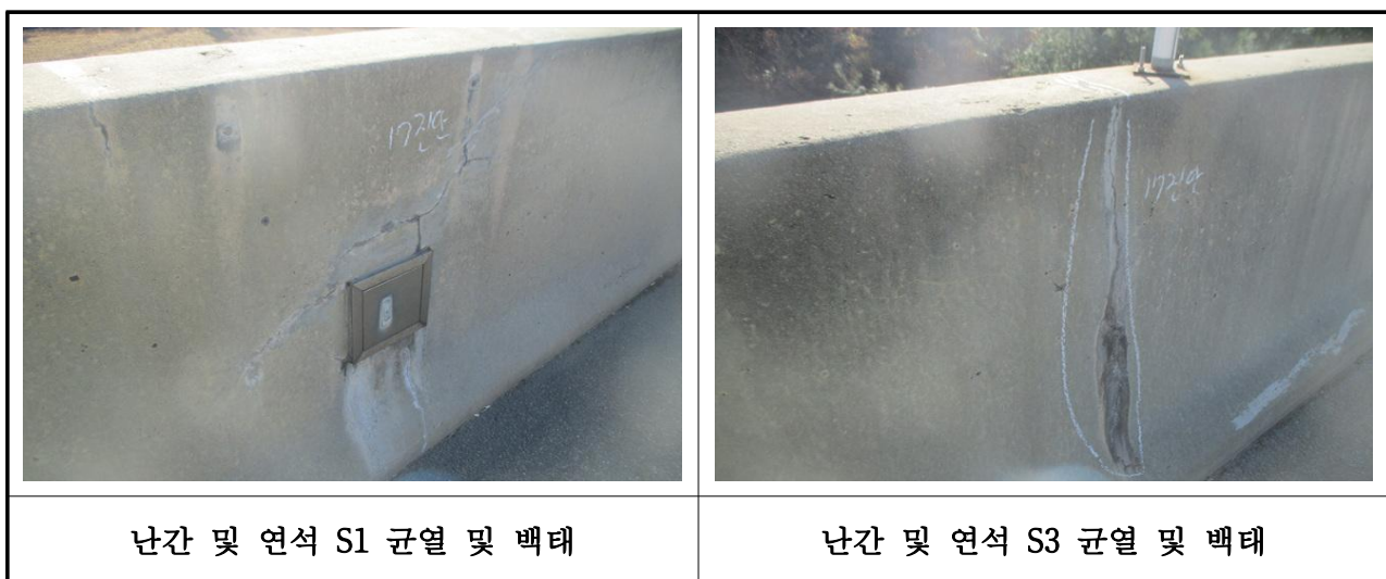
【사진 3.21】 난간 및 연석 손상현황
